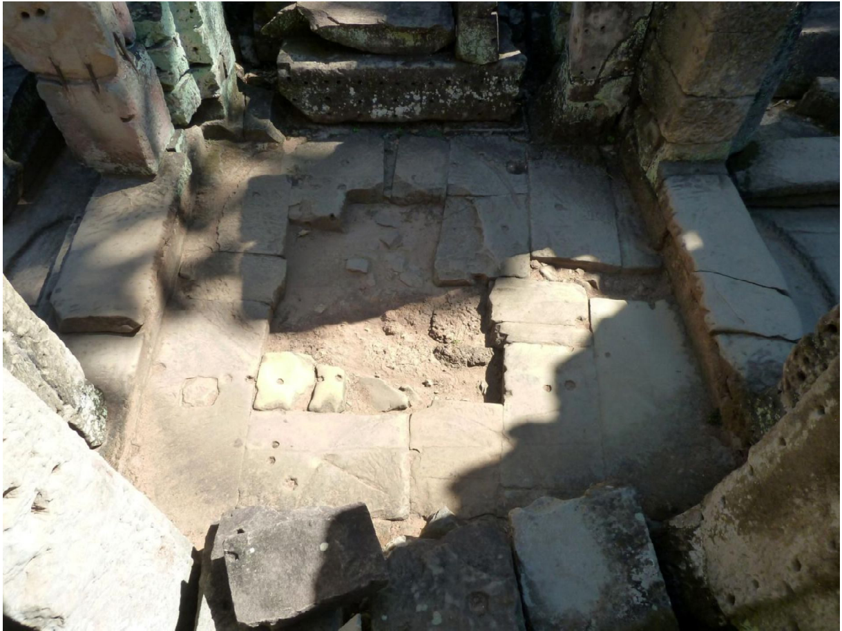
Photographie 14 : Prah Kahn, traces circulaires dans l'avant-corps oriental de la tour 2.
